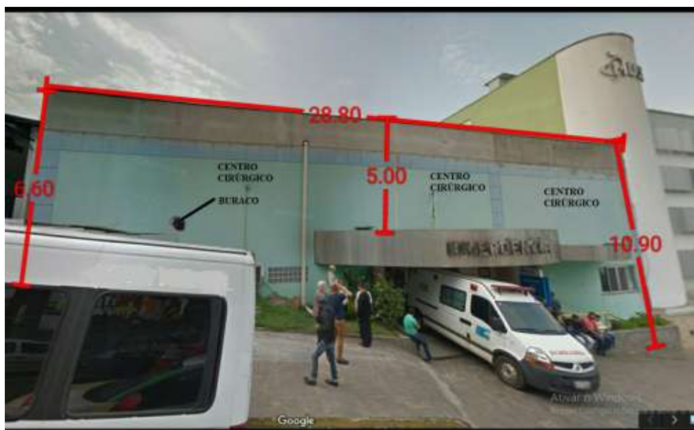
Imagem 1: Demonstrando defeitos da fachada e ampliação da platibanda. (Google)
