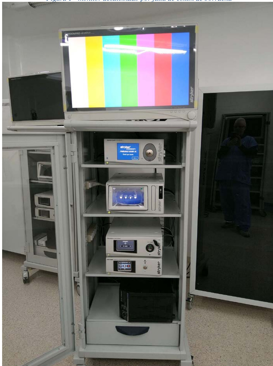
Figura 1 - monitor desalinhado por falta de coxim de borracha
